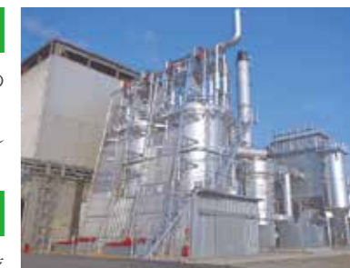
築港元町事業場 1号機・2号機
