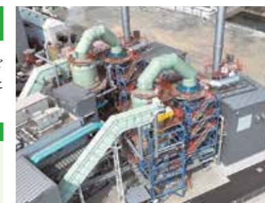
築港元町事業場 3号機・4号機
