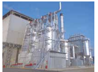
築港元町事業場 1号機・2号機
