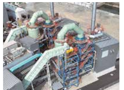
築港元町事業場 3号機・4号機
